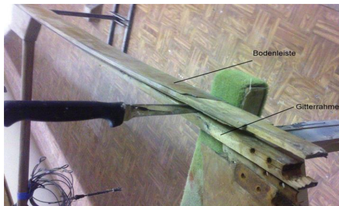
Vor der Reparatur
